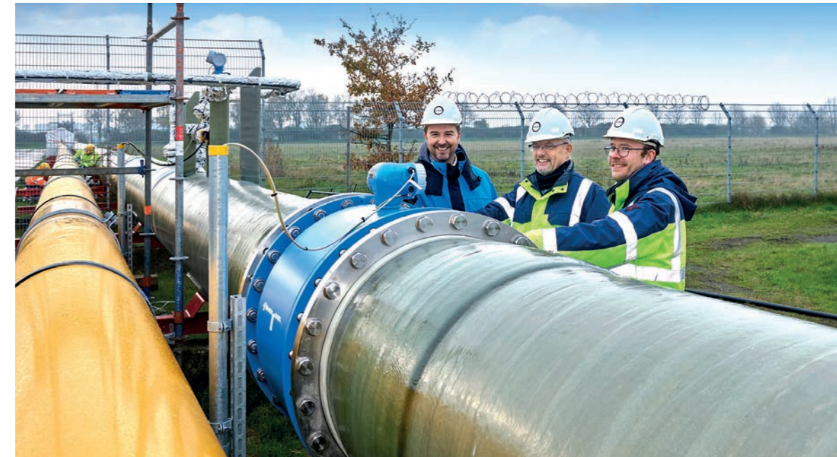
Neue Rohrleitung zum Elbehafen: (v.l.) Covestro-Standortleiter Victor Ortega, Betriebsleiter Rolf Heinrich Schlüter und Simon Brinkmann, Leiter Industriepark-Marketing. © Covestro
