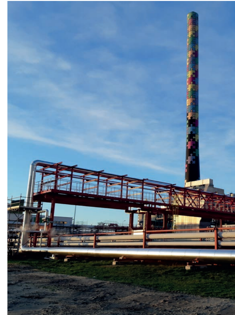
Rohrbrücke für die neue 20-bar-Dampfleitung im Covestro Industriepark Brunsbüttel. © Covestro
