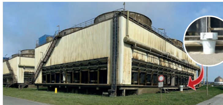
Kühltürme mit Einbindepunkt (kl. Bild) für die Rohrleitung zum LNG-Terminal. © YARA Brunsbüttel GmbH
